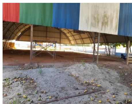
Figura 48 – Aspectos de irregularidade
