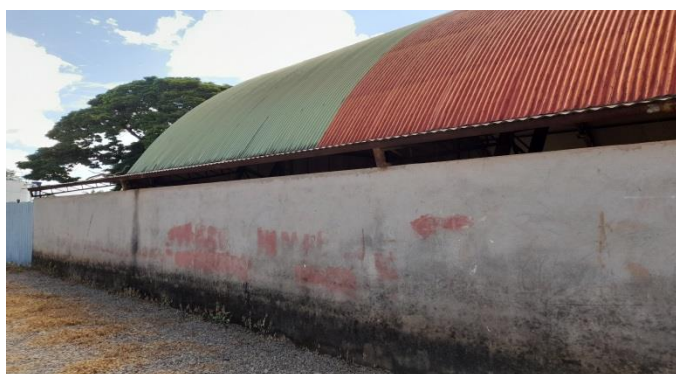
Figura 49 – Aspectos de irregularidade
