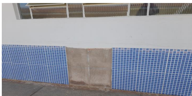
Figura 45 – Aspectos de irregularidade
