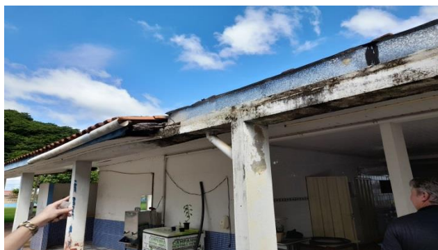
Figura 47 – Aspectos de irregularidade
