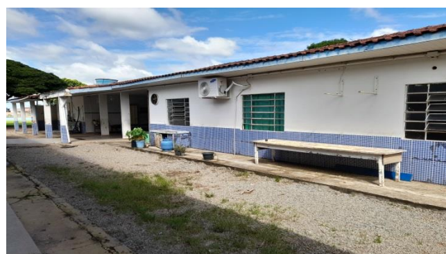
Figura 50 – Aspectos de irregularidade
