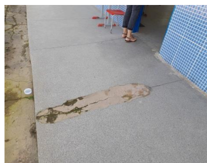
Figura 46 – Aspectos de irregularidade
